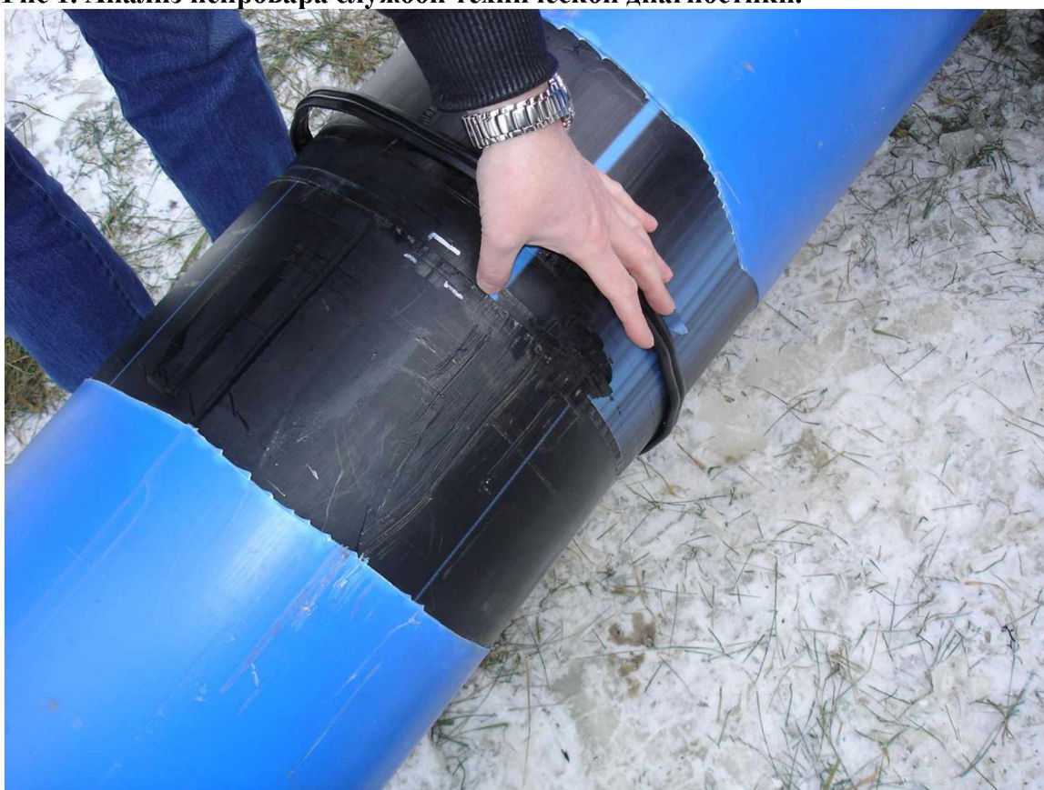
Рис.2 Выявление непровода непосредственно при строительстве.
