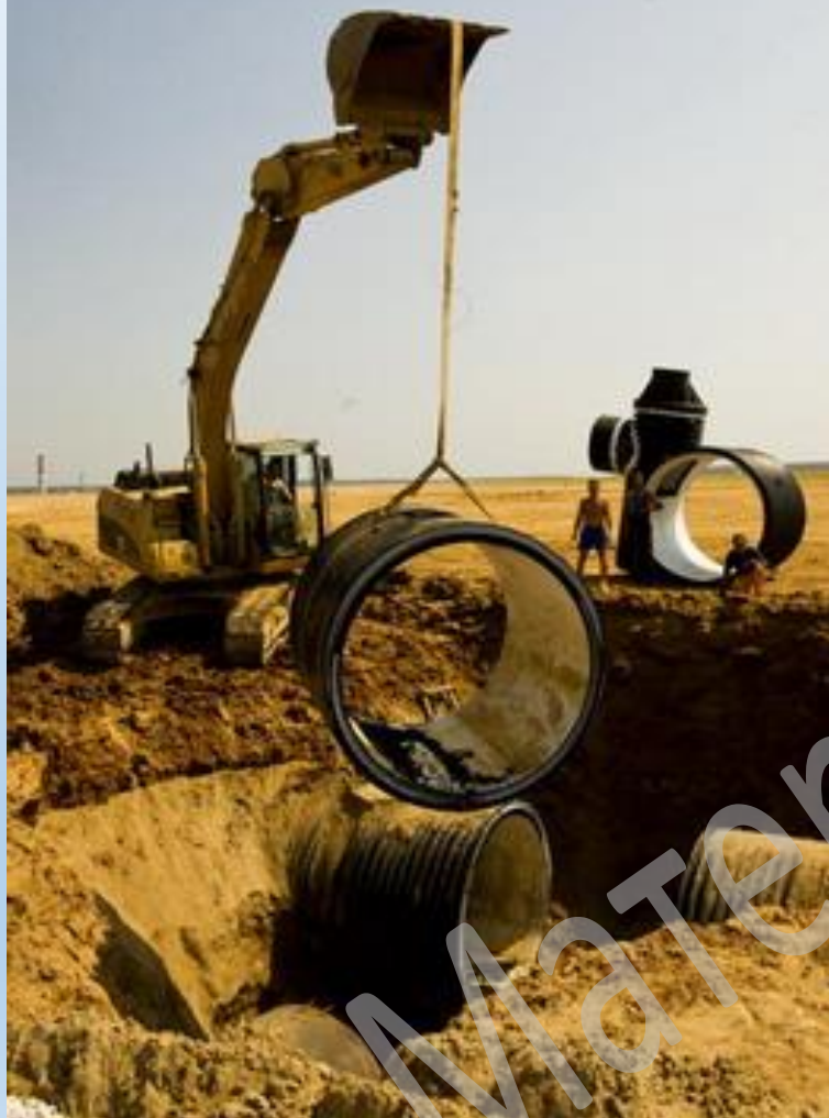
Вырезанный участок трубопровода
