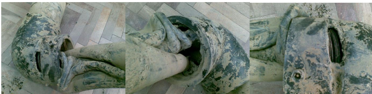
Рис.1. Отвод 160мм «сваренный» с грубейшими нарушениями технологии, что привело к возгоранию трубопровода.
